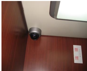
エレベータ内設置例
